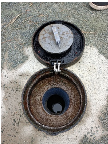
校内汚水枡，トイレマンホール 紛失防止用蝶番有り
