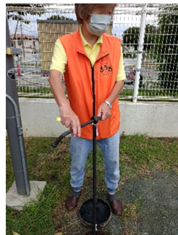
バルブマンホール
