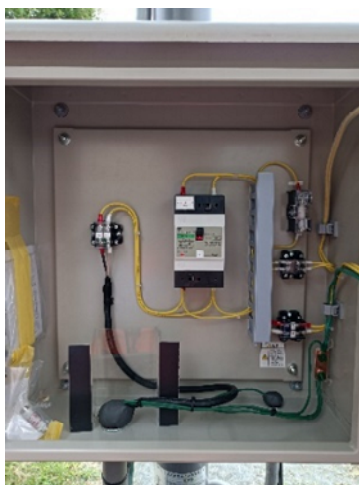
緊急用分電盤
