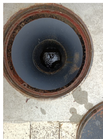
駐輪場汚水枡 紛失防止用蝶番無し
